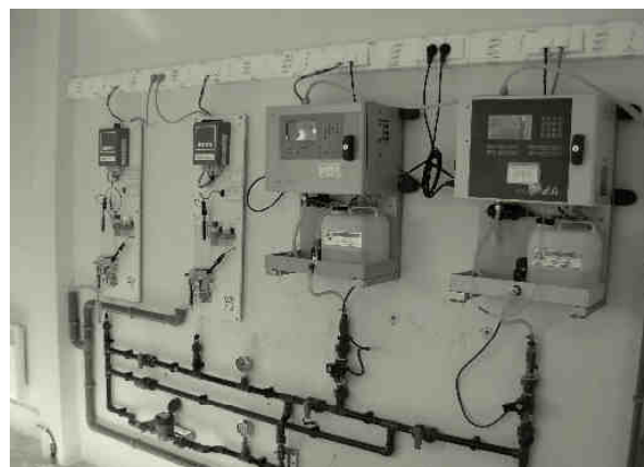
Les appareils de mesures du taux de nitrates de la station de pompage
